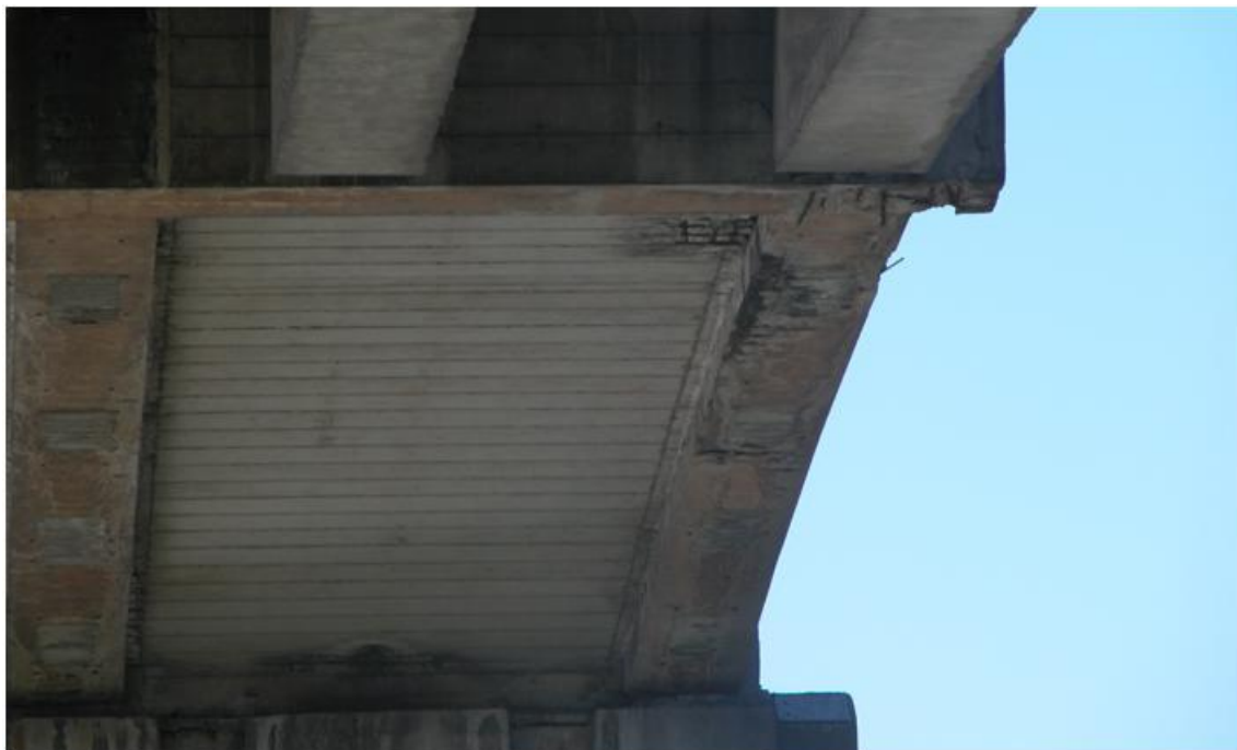
Figura 15. Corrosione sulle mensole in corrispondenza dell'appoggio delle travi.
