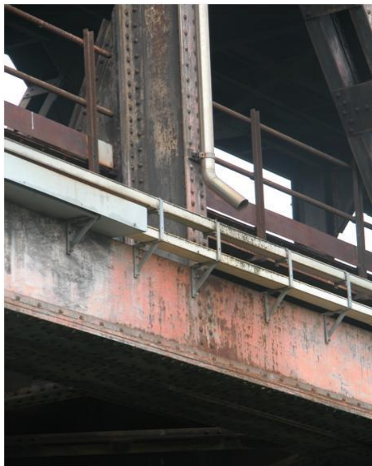
Figura 14. Leggero stato di corrosione in corrispondenza dei pluviali.
