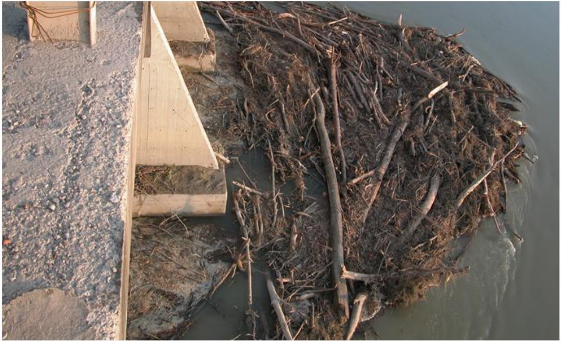
Figura 5. Accumulo di detriti a ridosso delle pile in alveo.
