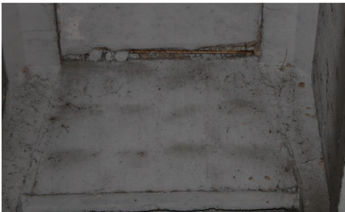
Figura 10. Distacco di copri ferro e barre di armatura sporgenti.
