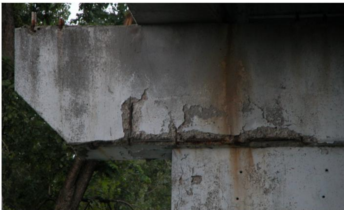
Figura 9. Distacco di copri ferro e corrosione sui pilastri.
