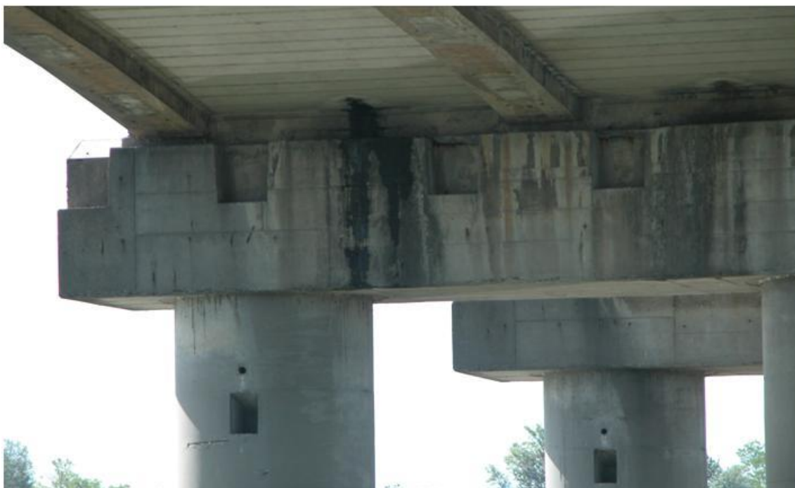
Figura 13. Tracce di umidità causate da un cattivo drenaggio dell'acqua.
