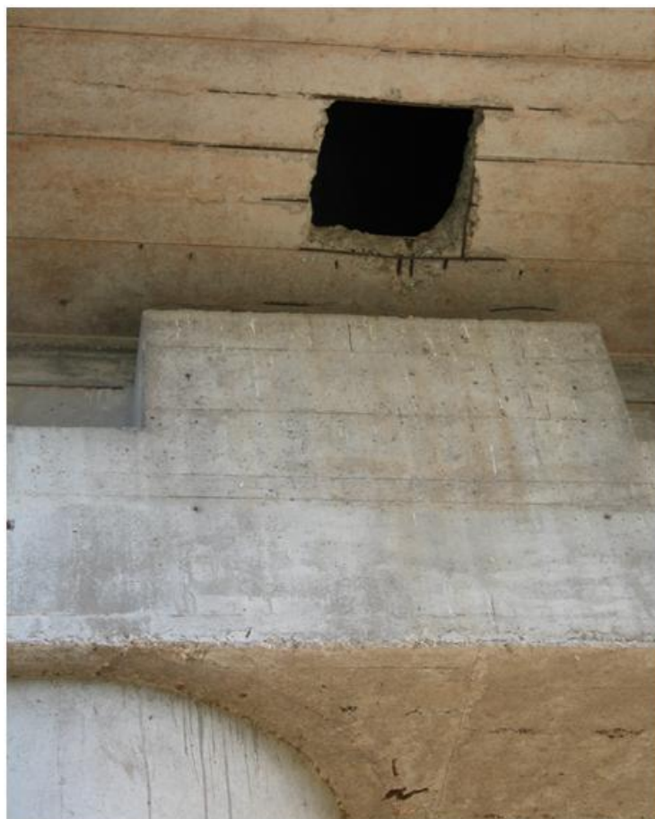
Figura 14. Fori aperti forse per manutenzione interna dei cassoni, ma non adeguatamente protetti.
