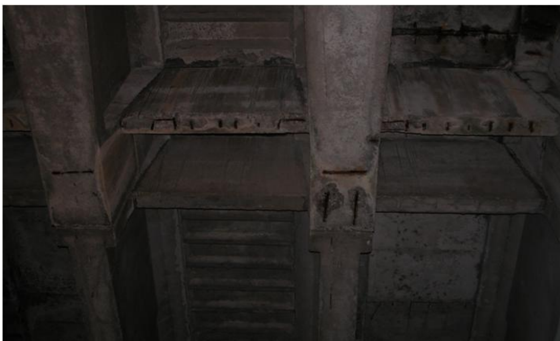
Figura 10. Stato di corrosione diffuso.
