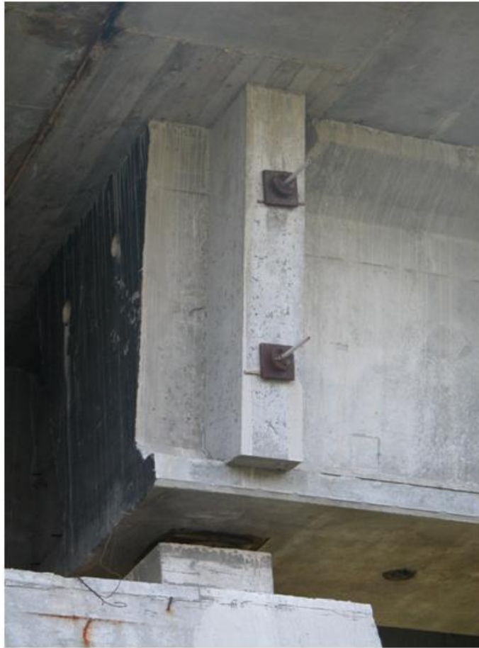
Figura 17. Particolare delle testate di precompressione trasversale non protette.
