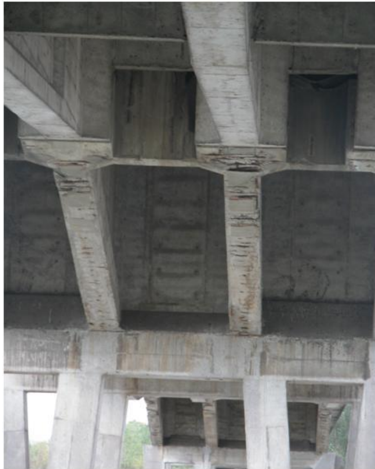
Figura 6. Diffuso distacco del copriferro.
