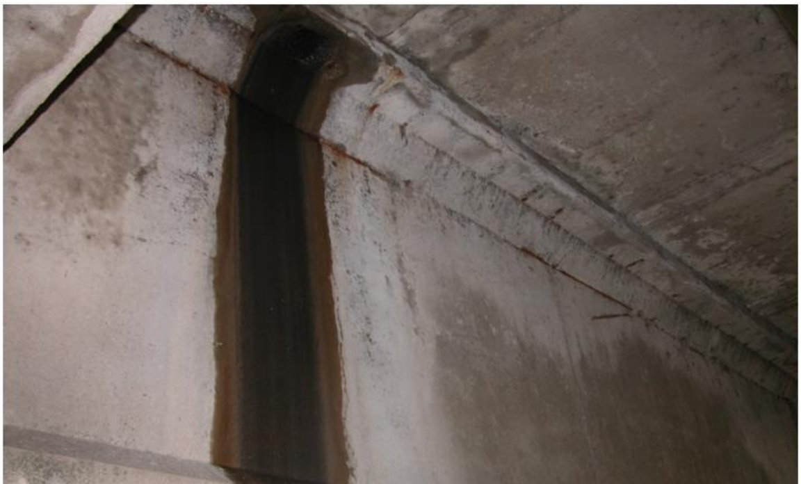
Figura 8. Totale mancanza di pluviali.
