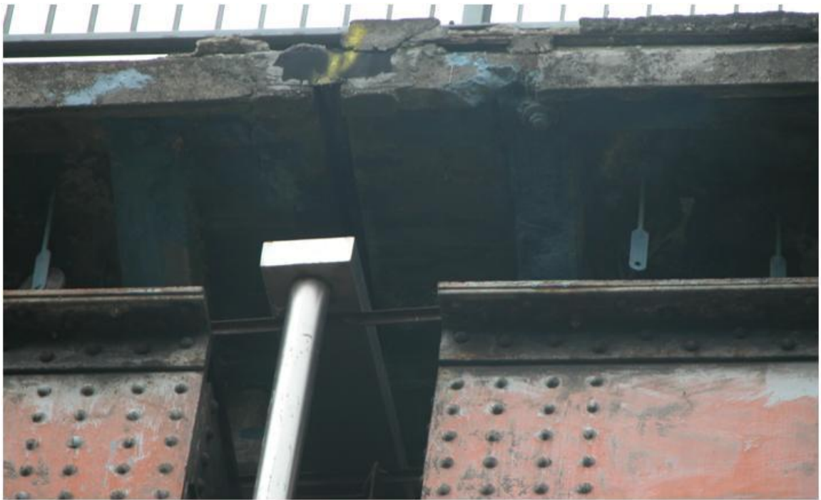
Figura 13. Distacchi di copriferro dal bordo della soletta.
