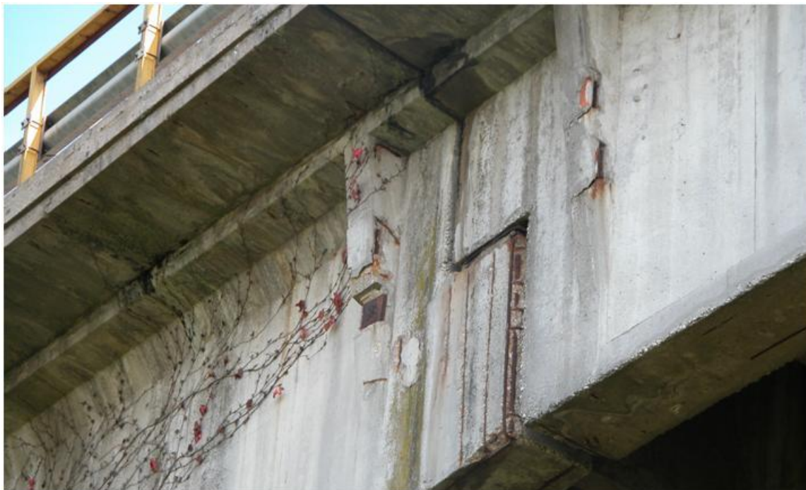
Figura 10. Testate di ancoraggio della precompressione trasversale scoperte in molti punti. Degrado sulla sella Gerber
