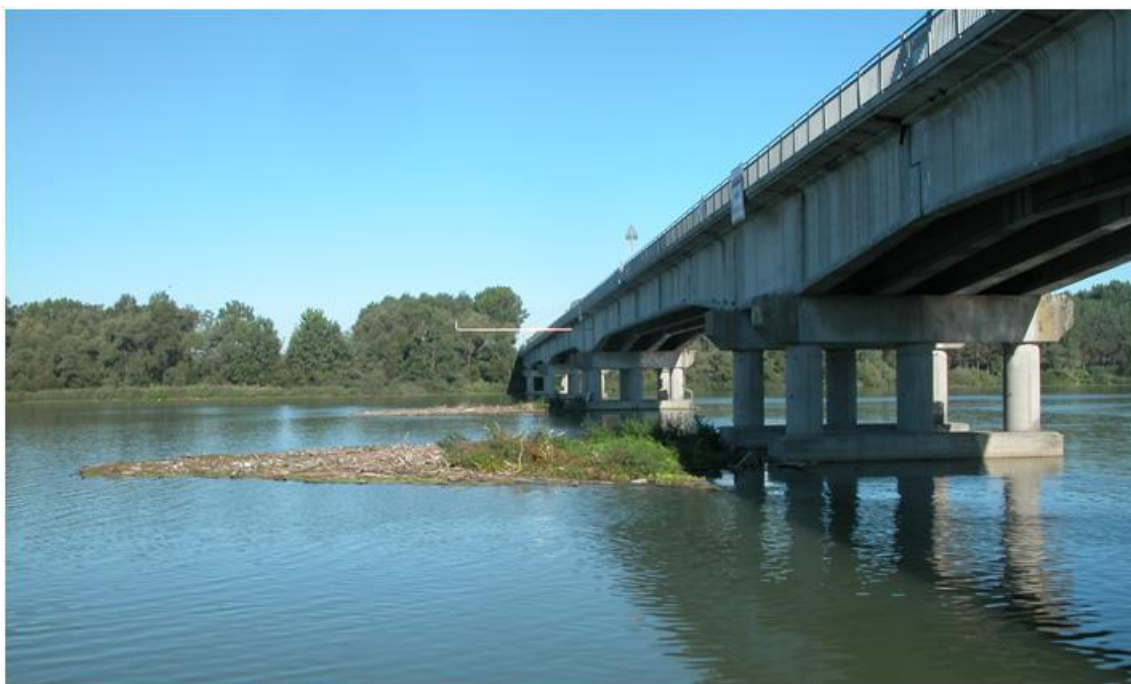
Figura 5. Vista dal basso delle travi dell'impalcato, deposito di ramaglie a ridosso delle pile.
