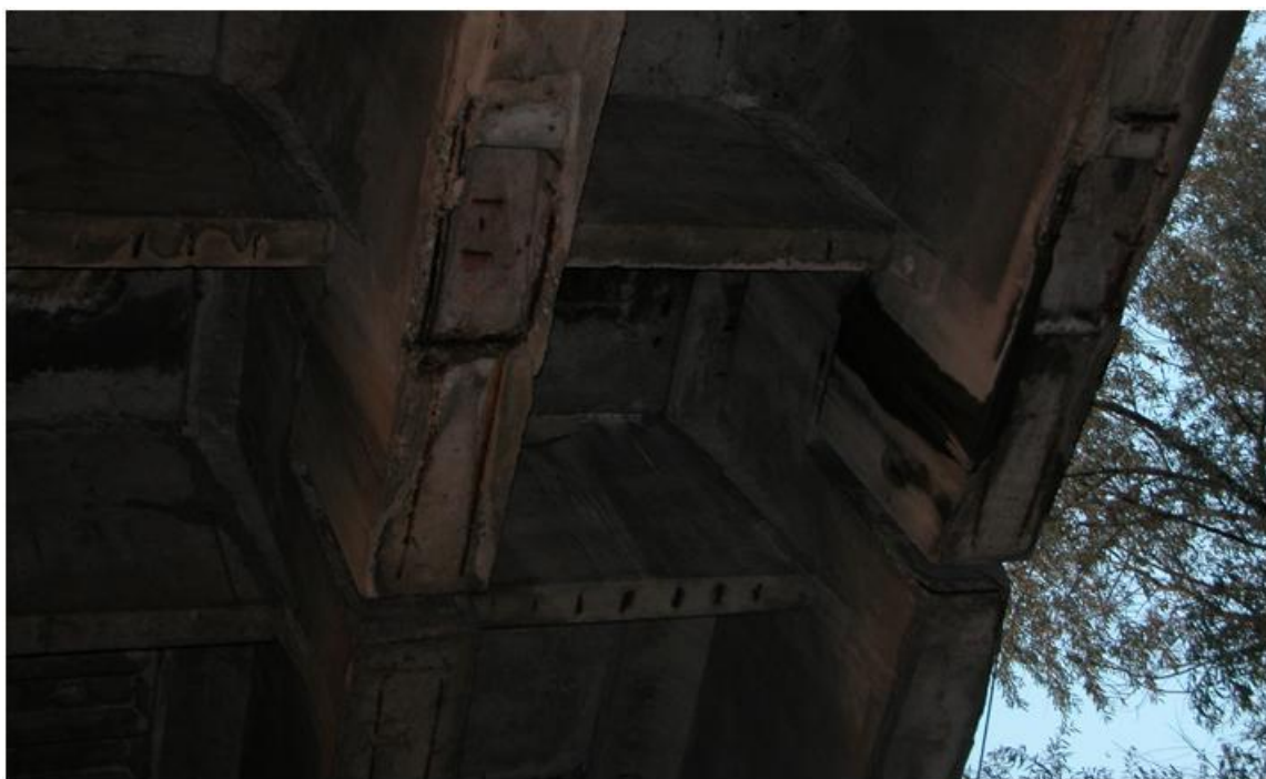
Figura 9. Corrosione delle barre di armatura in corrispondenza delle selle Gerber.
