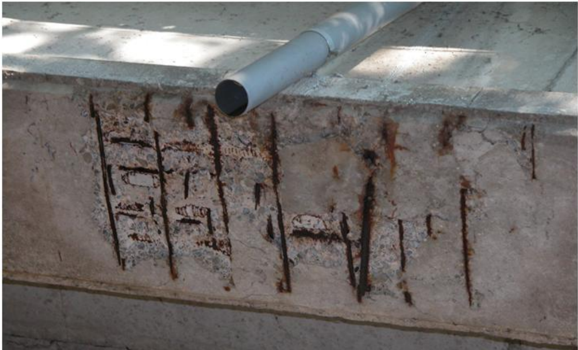
Figura 7. Nelle travi di campata il degrado ha esposto all'aria i cavi di precompressione.
