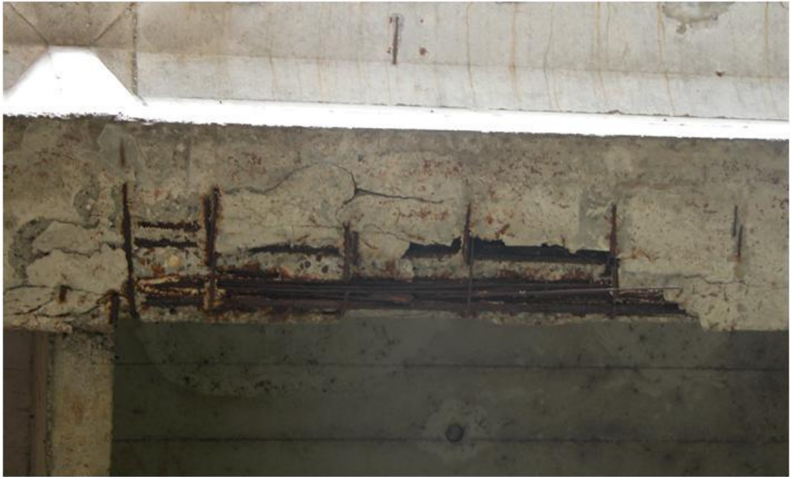
Figura 14. Probabile corrosione interna ad un cavo di precompressione.
