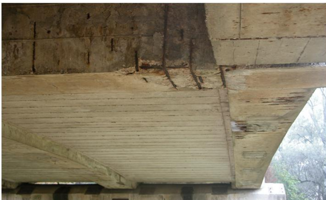
Figura 10. Distacco del copriferro e corrosione in corrispondenza della sella Gerber.
