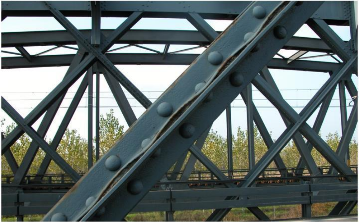
Figura 16. Formazione di ruggine nell'imbottitura di un profilo chiodato.
