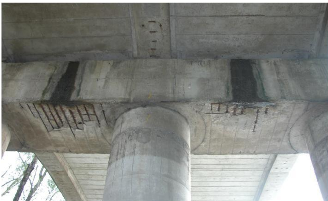
Figura 9. Distacco del copriferro e corrosione sui pulvini.
