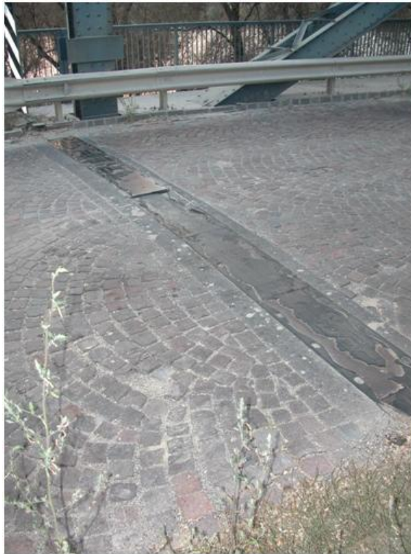
Figura 15. Pavimentazione in porfido con forti avallamenti.
