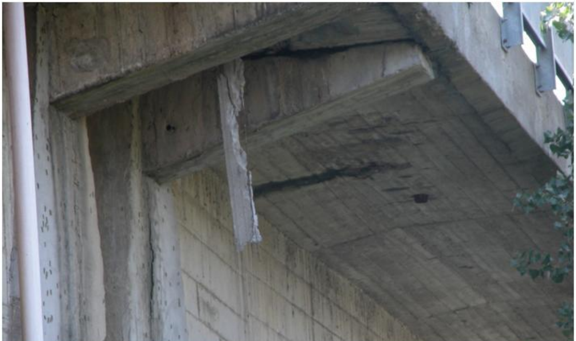
Figura 10. Mancanza di alcuni tubi di drenaggio, danneggiamento locale del calcestruzzo.
