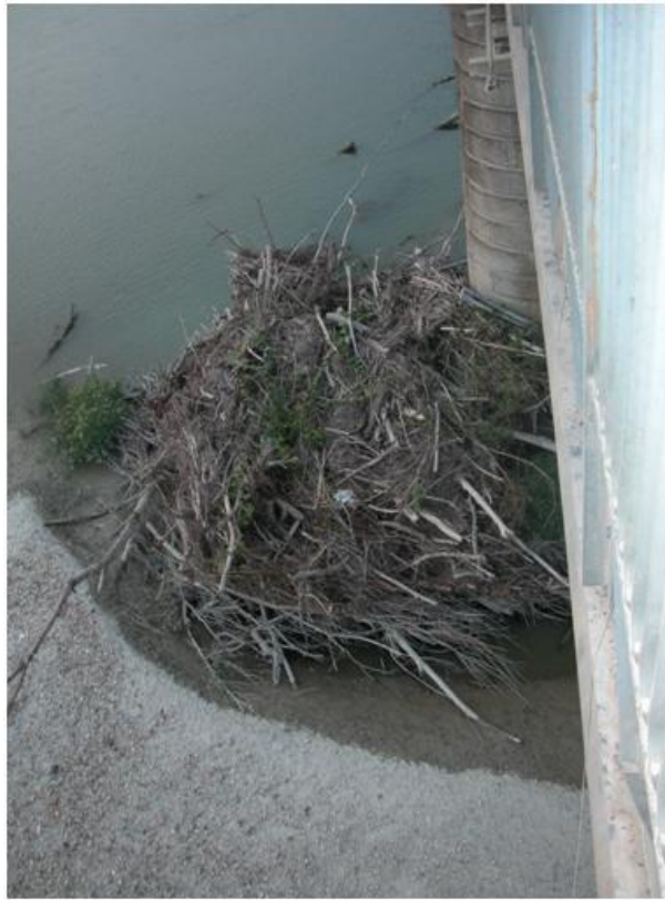
Figura 16. Forte accumulo di ramaglie contro le pile.
