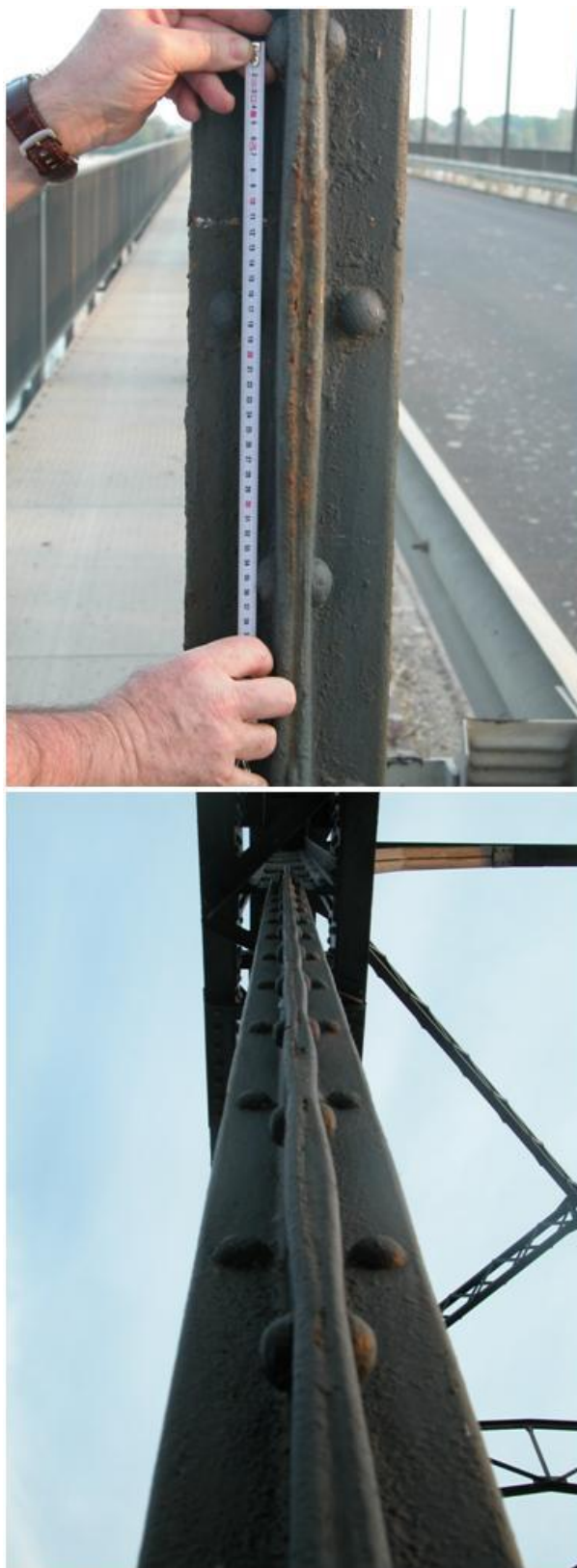
Figura 13. Rigonfiamento dei profili chiodati (tiranti) a causa della corrosione interna.
