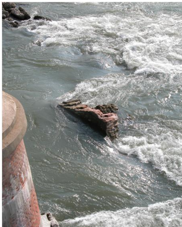
Figura 6 - Presenza di detriti di strutture in muratura a valle delle pile.
