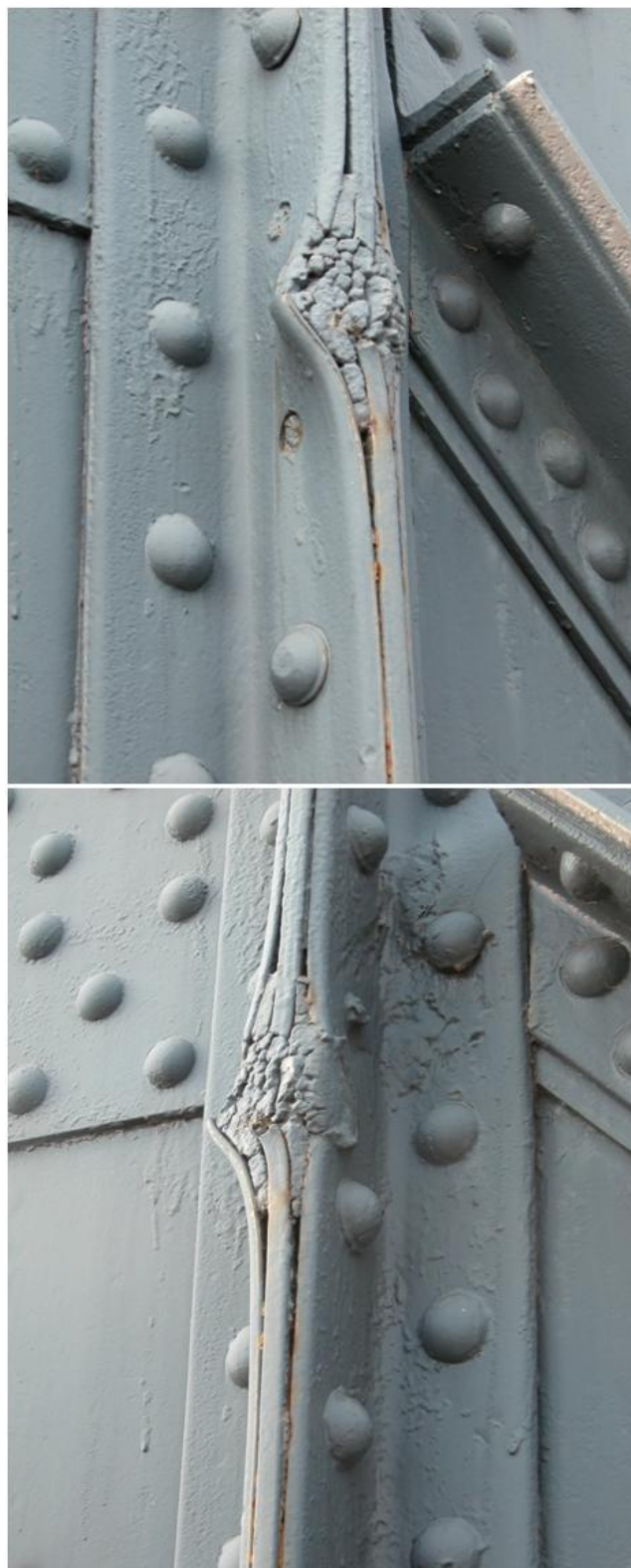
Figura 15. Formazione di ruggine nell'imbottitura di un profilo chiodato, rottura della lamiera e di due chiodi.
