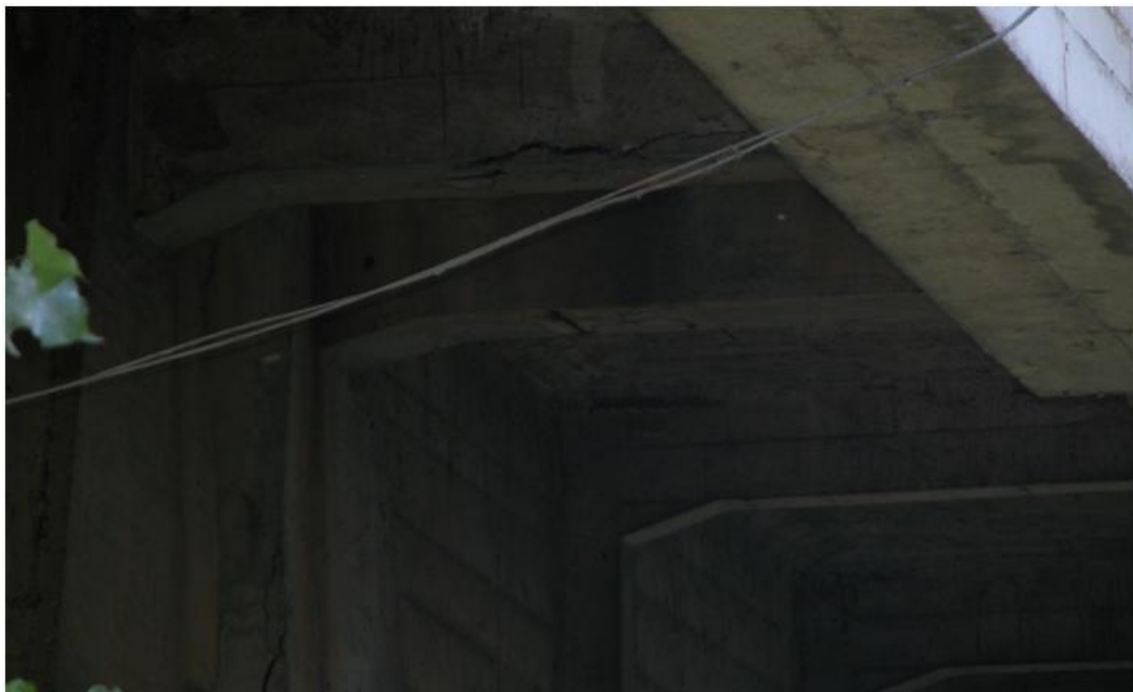
Figura 8. Particolare di un traverso fessurato con imminente distacco del copriferro.
