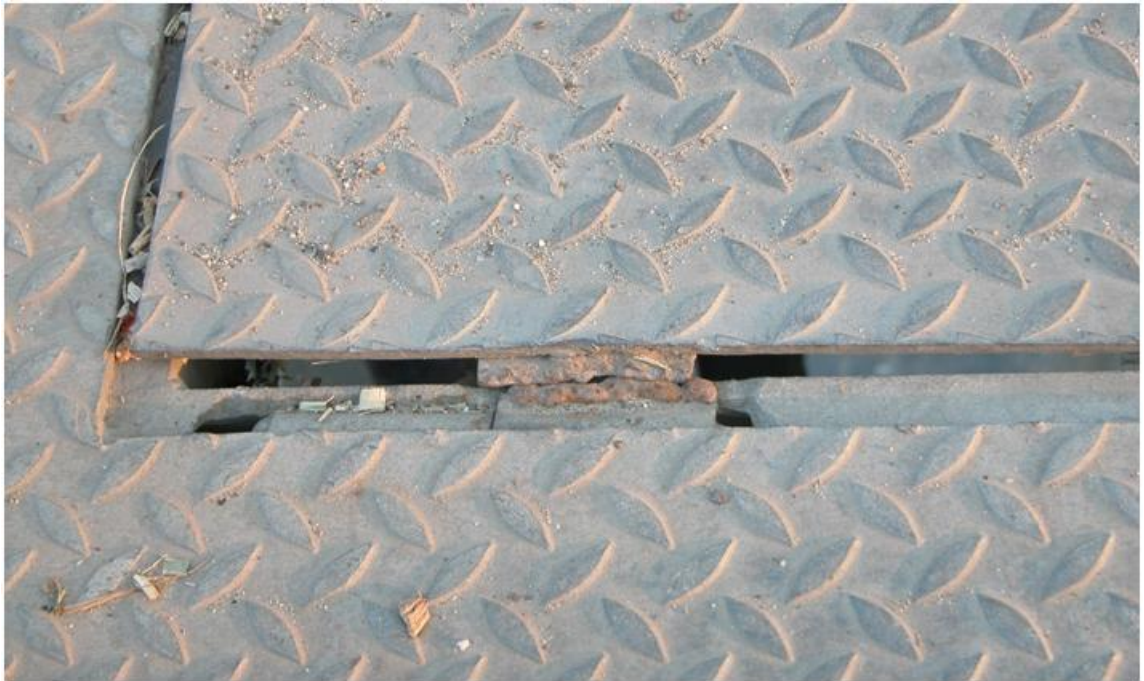
Figura 14. Botola di accesso alla struttura dai camminamenti con cerniere rotte.
