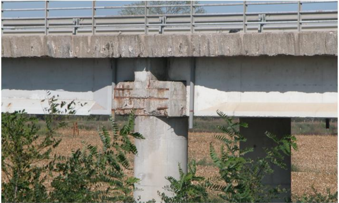
Figura 13. Distacco di copri ferro e corrosione sui pilastri.
