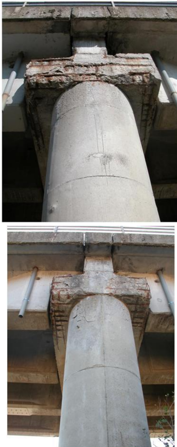
Figura 14. Mensole di appoggio deteriorate.
